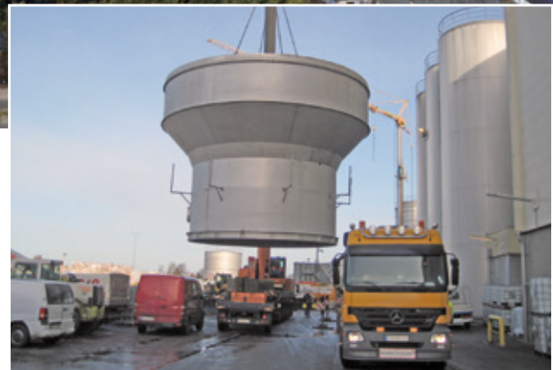
Metso Paper Karlstad Project, México: pré-fabricação e supervisão de todos os contêineres e torres de uma máquina de lençõs de papel
