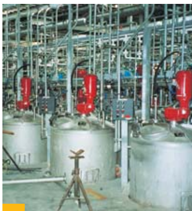
Wypolerowane elektrolitycznie orurowanie zbiorników dla Fabryki Farb (Feldmann/CH, 1999)
